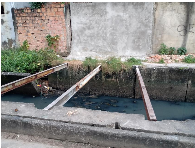
Foto 7 Trecho de desmoronamento da margem
